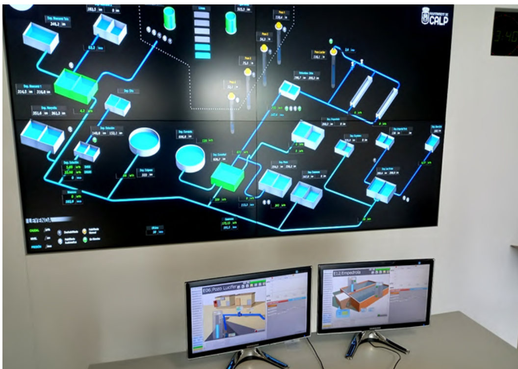
Centro de control de las oficinas de Aguas de Calpe
